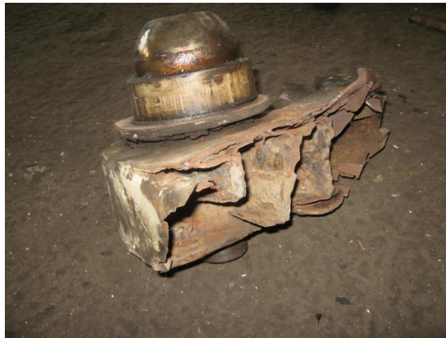
Рисунок 5 – Отрыв крепления шаровой опоры из-за сквозной коррозии металла
